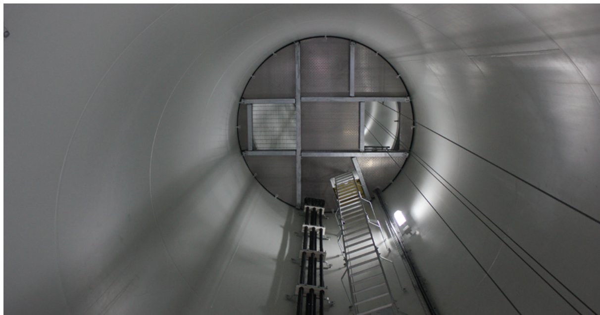
FOTOGRAFÍA 4. Vista del interior de una torre de un aerogenerador
